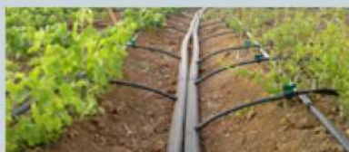
Approvisionnement en eaux souterraines
